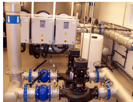
Fre renseanlegget på Vassverket
